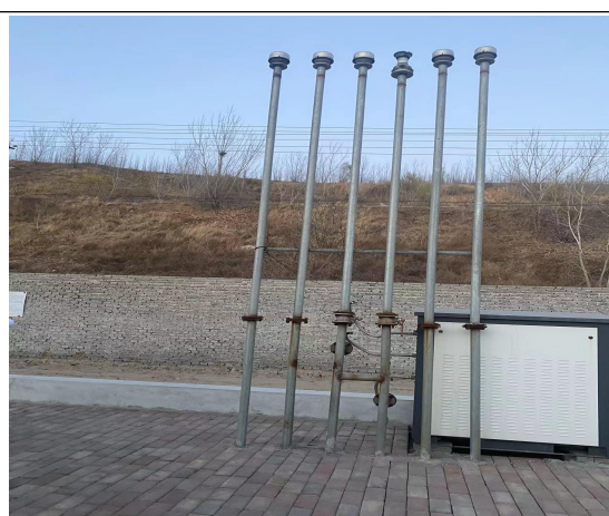
通气管口和油气回收装置
