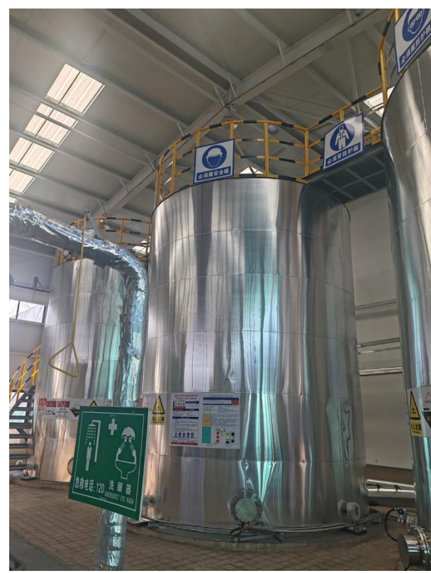
氢氧化钠储罐区
