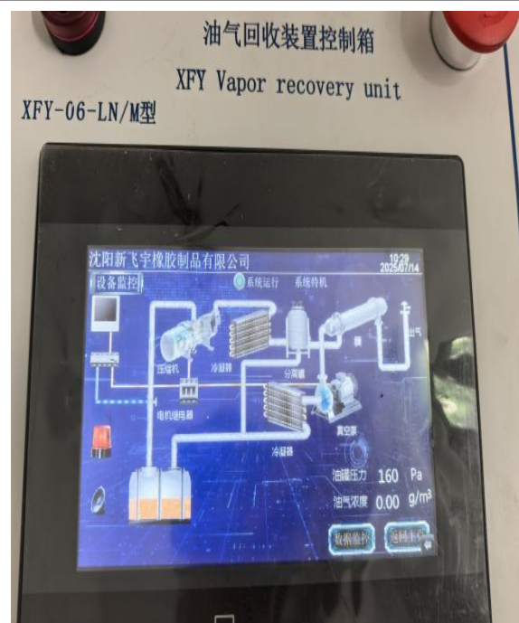
油气回收装置控制箱
