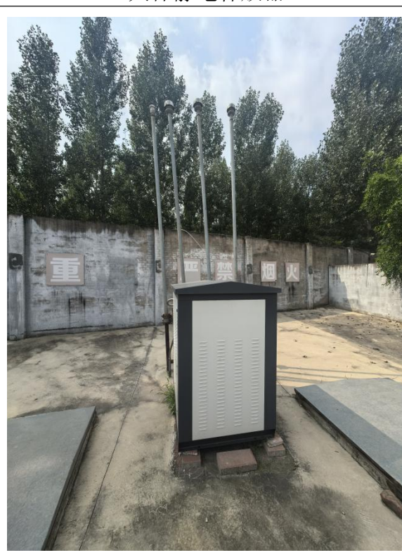
三次油气回收装置、通气管
