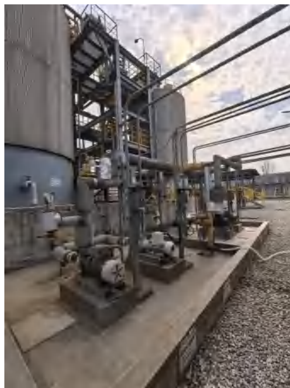
原料罐区泵区
