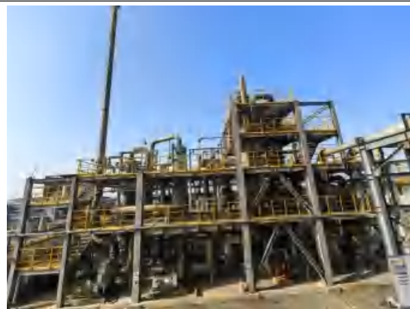
氯化氢回收装置
